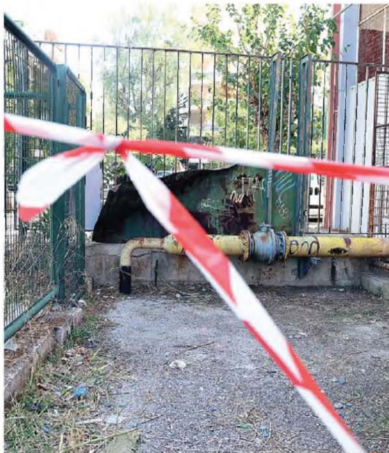
Κλειστό θα συνεχίσει να είναι το σχολικό συγκρότημα της Γκράβας, καθώς έλεγχοι για την προέλευση της οσμής θα συνεχιστούν και χρειάζεται να γίνουν τεχνικές παρεμβάσεις στην εγκατάσταση του φυσικού αερίου, που ελέγχθηκε πλήρως για πρώτη φορά από όταν τοποθετήθηκε.
