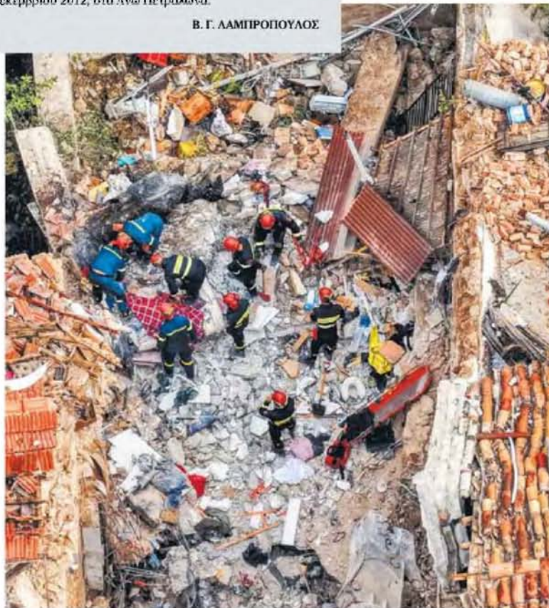
► Επισήμανση έρευνας και διάσωσης στα συντρίμια του κτιρίου στην οδό Αυσικράτους στην Πλάκα
