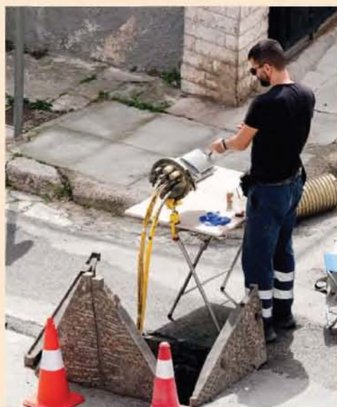
Αφού διαπιστωθεί ποιος πάροχος έχει αναπτύξει υποδομή οπτικής ίνας στην περιοχή, ο διαχειριστής, με τη συναίνεση των ιδιοκτητών, επιλέγει την εταιρεία που θα εγκατασταθεί το κεντρικό κουτί στο κτίριο. Από εκεί και πέρα, όμως, αρχίζουν οι δυσκολίες.
