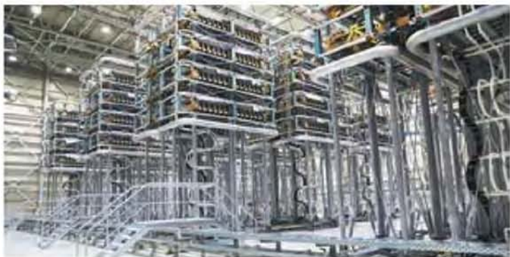
► Ο προϋπολογισμός του έργου για τους Σταθμούς Μετατροπής της διασύνδεσης Κορίνθου - Κω ανέρχεται σε 809,1 εκατ. ευρώ
