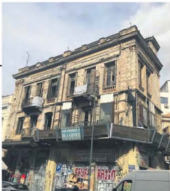
Τα εγκαταλελειμμένα κτίρια από τους ειδικούς έχουν χαρακτηριστεί ως εν δυνάμει βόμβες, αφού κατά το παρελθόν είχαν σημειωθεί περιστατικά κατάρρευσης.
