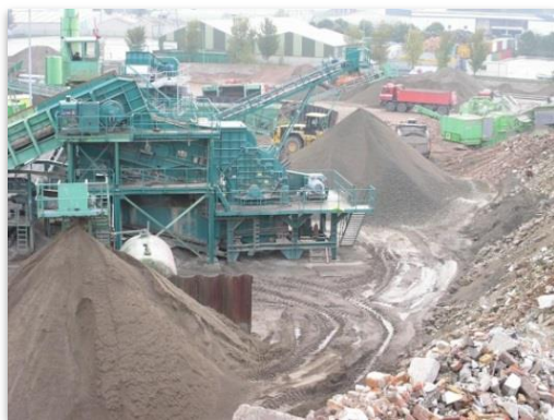
Μονάδα ανακύκλωσης αποβλήτων Κ&Κ. Πηγή: FIR
